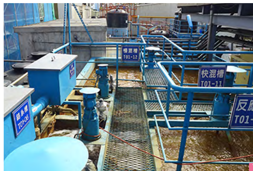
1 2 3 自動化廢水處理 Automatic Waste Water Treatment
